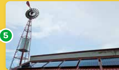
5 캠프 딸락 지속가능발전센터 재생에너지 설비 구축 (태양광 및 지하수 개발) (6월) Installed the Renewable Energy in the CAMP Sustainable Development Center(Solar & Wind Power)
